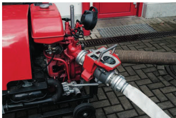
Abb. 4.4: Prüfung einer TS-Pumpe mit Auslaufstrecke und Druckvernichter am Ende
