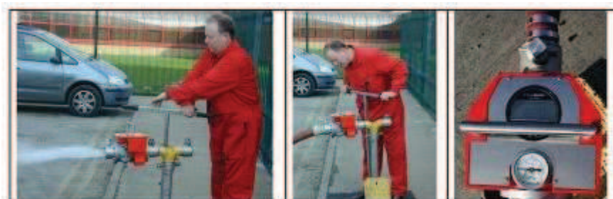
Abb. 3.1: Überprüfung eines Unterflurhydranten mit einem Standrohr. Beispiel für Durchflussmessung und Ablesen des Restdrucks. Fotos mit freundlicher Genehmigung von Essex County Fire and Rescue Service und Laois Fire Service.
