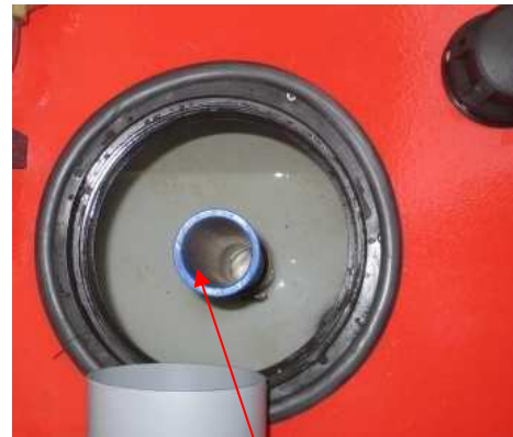
Tankeinfüllstutzen mit Überlauf
