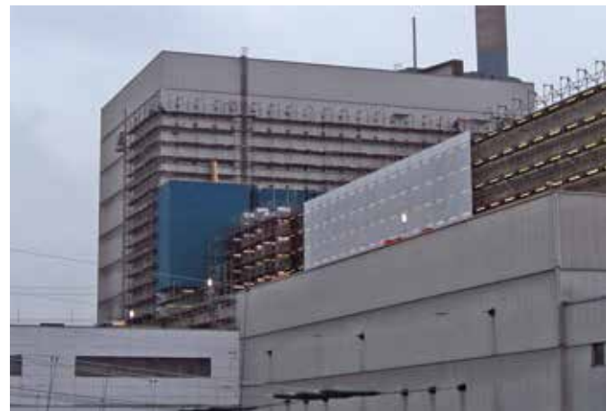
Gerüstausleuchtung auf einem Industriegebäude
